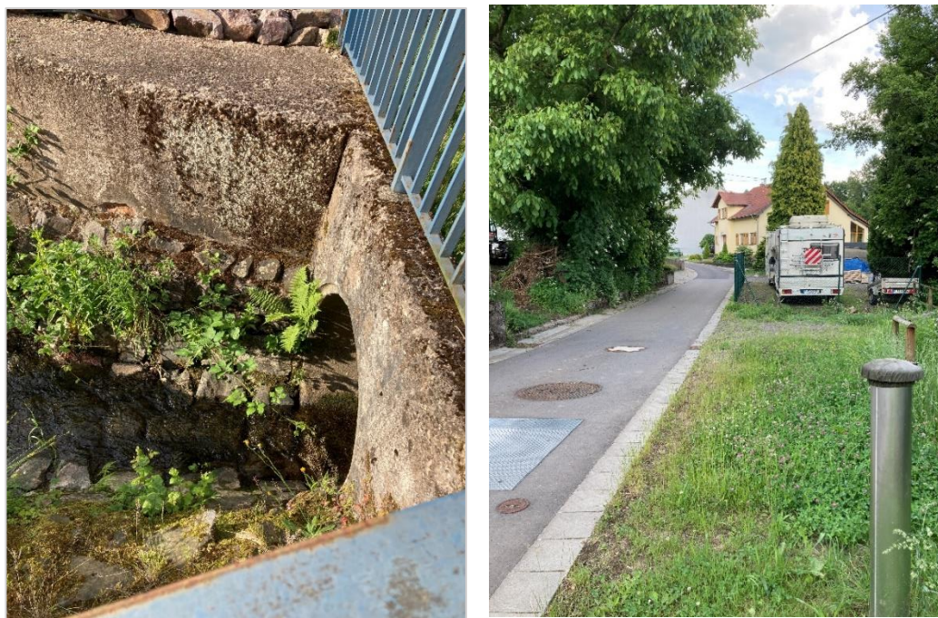
Abb. 18: Einlauf des Steinbachs in die Verrohrung in der Bachstraße und potentiell überschwemmter Bereich in der Bachstraße (P&P GmbH 2022)
