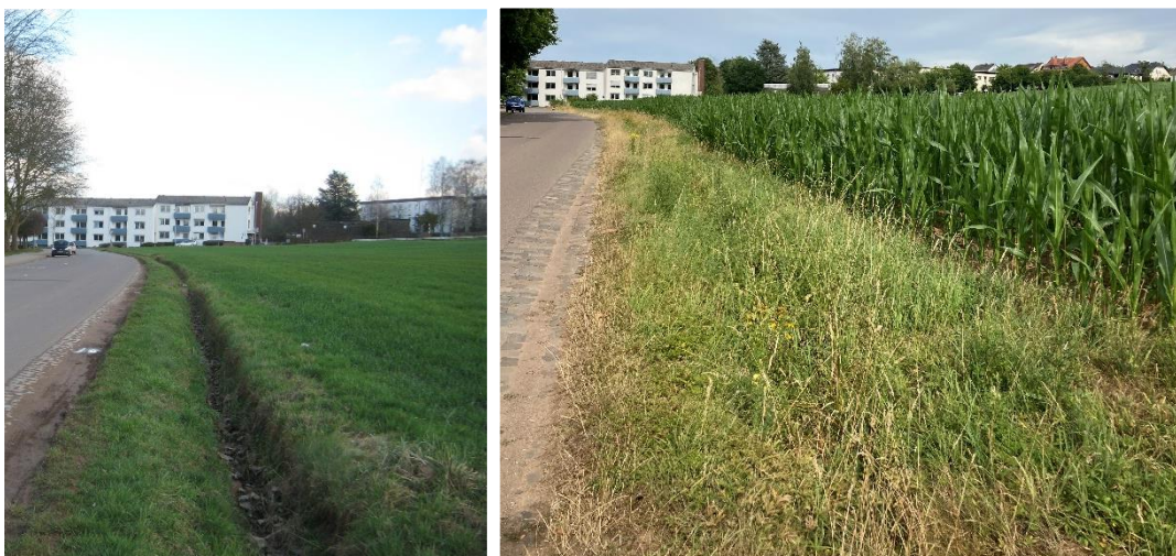
Abb. 59: Entwässerungsgräben nach Fertigstellung und bei fehlender Unterhaltung (P&P GmbH 2022)
