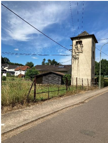
Abb. 6: Trafostation in Gewässernähe (P&P GmbH 2022)
